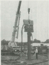
振動小さく市街地工事に対応 パイプロハンマー導入 パイプロハンマーは、振動が小さく、騒音が少ないことから、市街地工事での導入が進んでいます。パイプロハンマーは、振動が小さく、騒音が少ないことから、市街地工事での導入が進んでいます。
